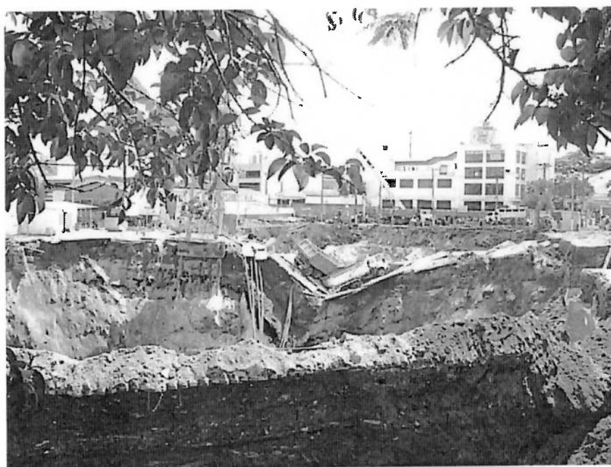
Figura 5 – Foto de parte da rua que foi engolida pela cratera
