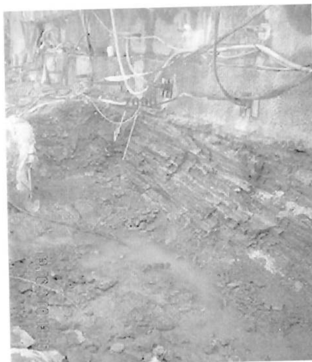
Figura 17 - Aspecto da superfície serrilhada de ruptura. Vista do sentido do poço à direita, parede ao lado da Abril
